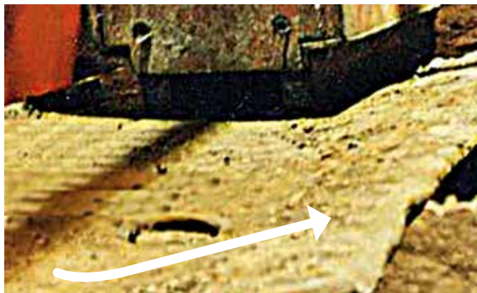
Abb. 2: Verformung der Stahlplatten auf dem Pfannenrand
